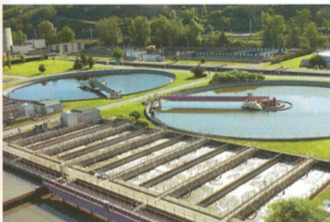
Fig. 4 Unités de brassage dans une station d'épuration.
